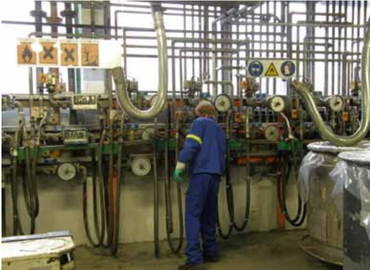
Abbildung 9: Lösemittelabfüllstation mit flexibler Objektabsaugung
